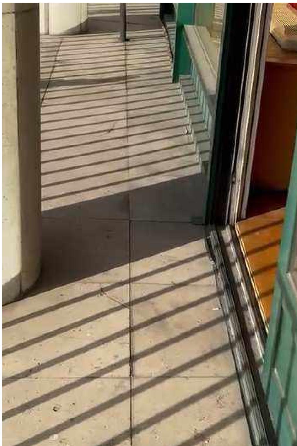
14. kép erkély kijárat csatlakozása a II.sz tanácsteremből (törött lapok) (Fáy2025)
