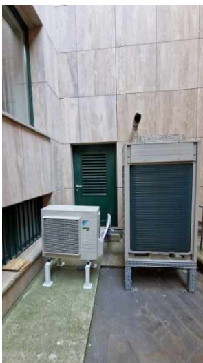
Áthelyezendő hőszivattyú a belső udvarban
